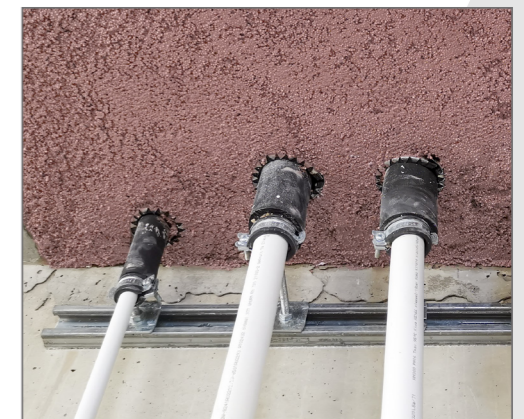
Deckenunterseitig bündig eingesetzte Brandschutzmanschetten
